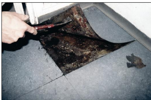
Skimmelsvamp under gulvbelægning (Kilde www.skimmel.dk )
